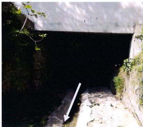
Figure 23 : Photographie de la partie souterraine entre l'avenue du Campon et l'amont de la rue Mérimée
